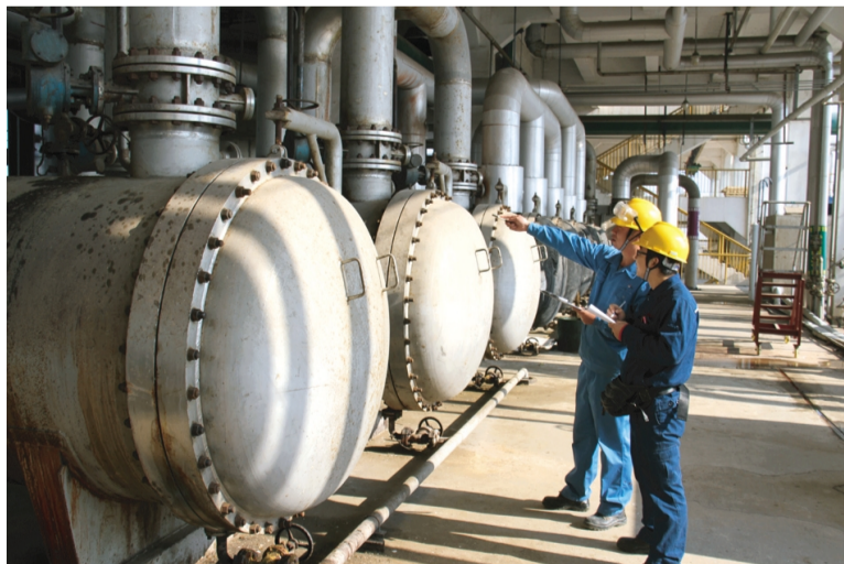
随着近期双氧水市场行情好转,11月1日,利海化工公司双氧水装置恢复生产,全公司上下进一步坚定信心,攻坚克难,决战四季度,奋力向全年目标任务发起冲刺。图为公司安全管理人员在检查设备安全运行情况。(葛高任)
